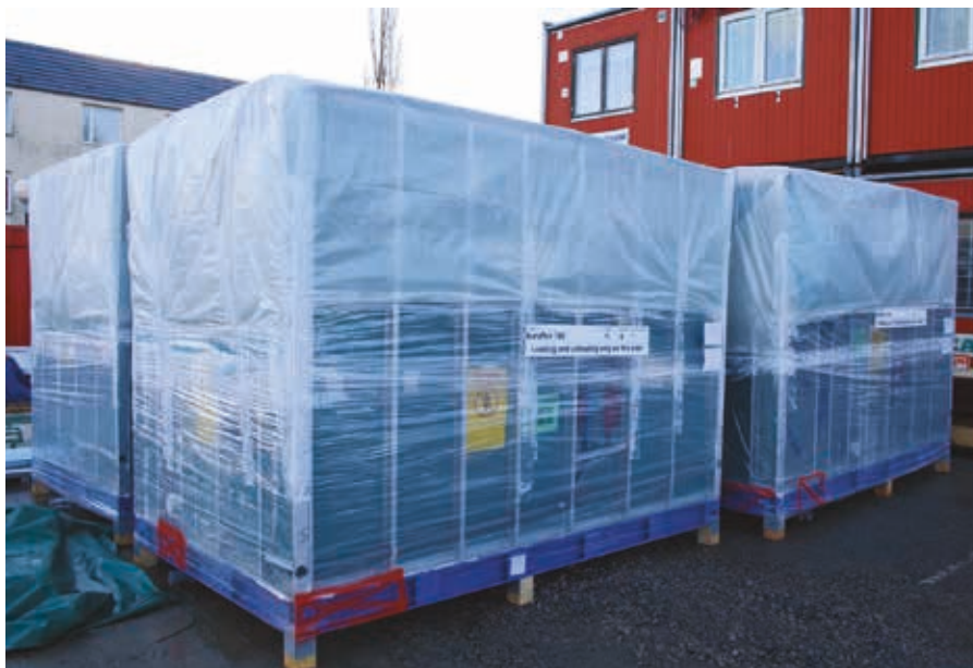
Badrum på väg! Badrummen till Karaffen kommer hööt färdiga, i inplastade paket - kompletta med kakel på väggarna och handdukshängare på plats! Bara att lyfta in i våningsplanet och koppla ihop med el, vatten och avlopp!
